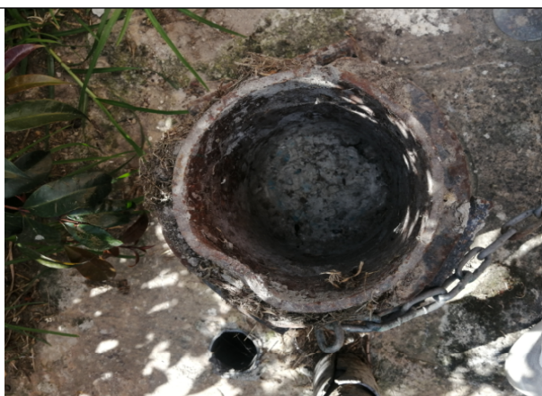
Interior de la capatación.
